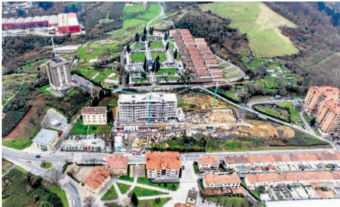
Imagen del estado de construcción de las obras el pasado mes de enero. :: AYUNTAMIENTO
